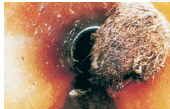
Schadensbild durch Wurzeleinwuchs
